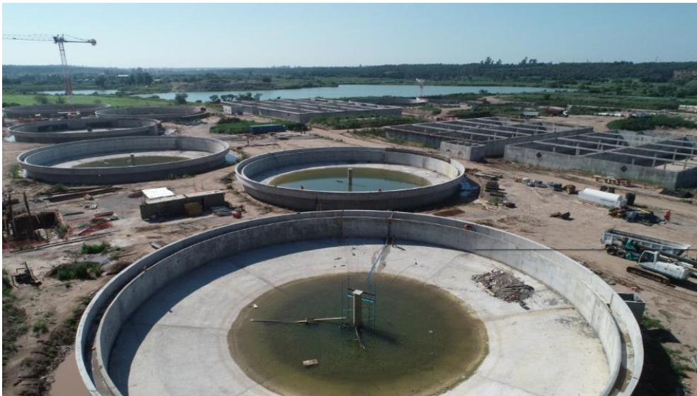
Estación Depuradora de Aguas Residuales (EDAR) de Bajo Grande, Córdoba
