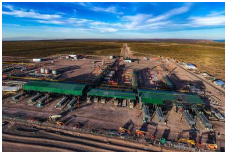
Instalaciones de Tecpetrol en Vaca Muerta – Neuquén
